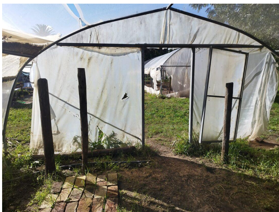
Figura 2. Cubierta de polietileno rasgada (con perforación) y media sombra deteriorada; estructura metálica sostenida con postes de madera.
